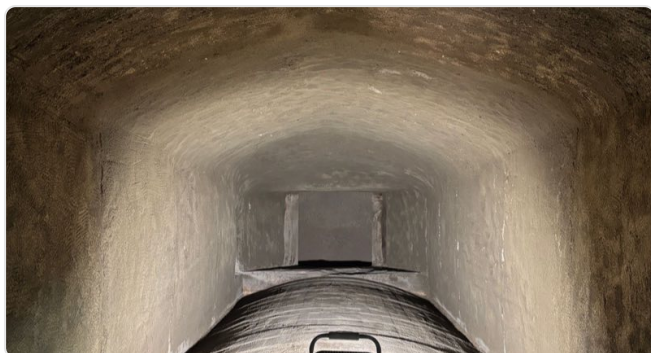
Formarea depunerilor pe căptușeală
