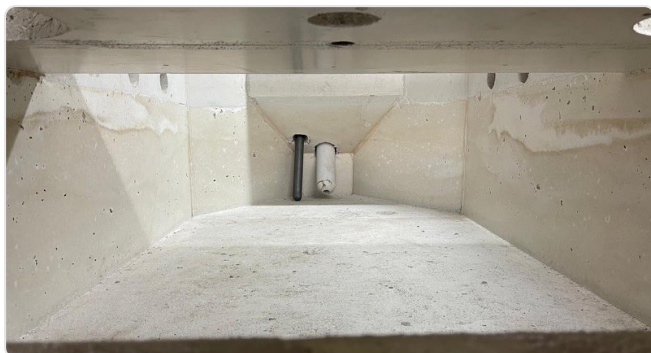
Cuptor de dozare: geometrie strânsă, contact permanent cu metalul
