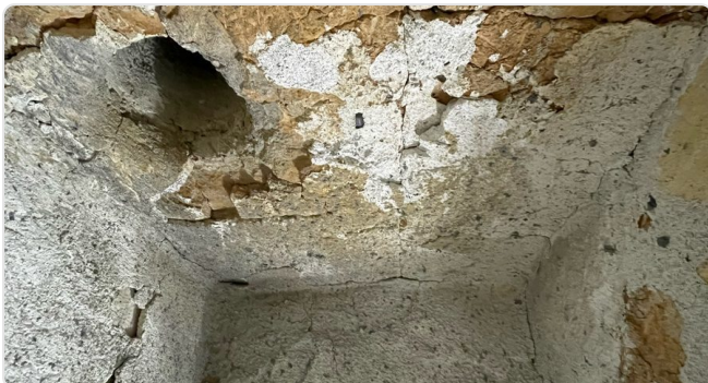
Gerissene und verfärbte Fläche mit Abplatzung — sofort handeln
