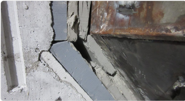
Befund: Die Zustellung ist bis an den Stahlmantel gebrochen
