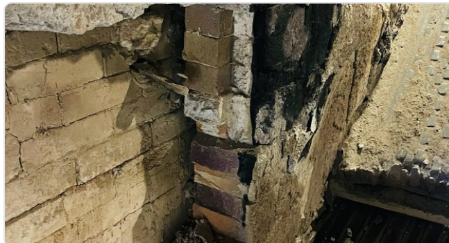
Fissura na transição de alvenaria para massa monolítica: observar
