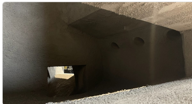
Passagem: cada junta aberta aspira ar falso
