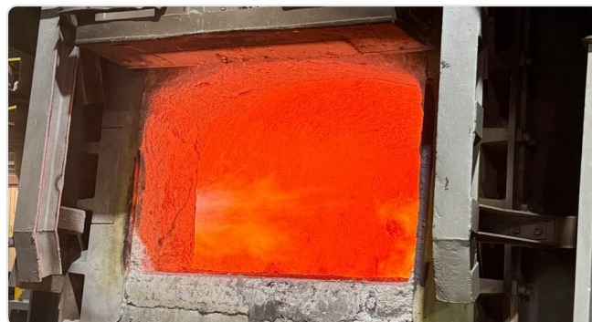
Revestimento incandescente em serviço
