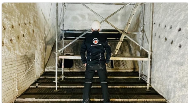
Revestimento de uma instalação de combustão de madeira
