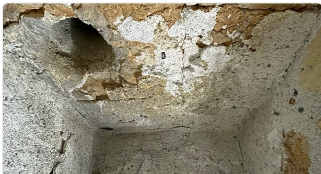
Spękana i przebarwiona powierzchnia z odpryskiem — działać natychmiast
