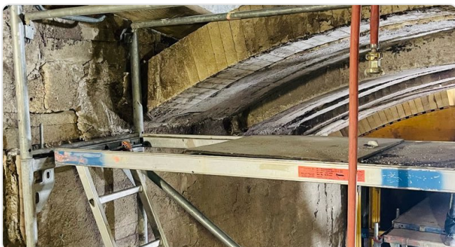
Termografia w trakcie ruchu pokazuje, gdzie mur ustępuje
