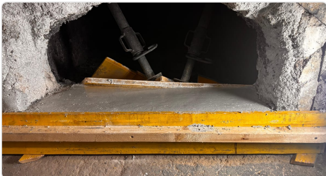
Otwór wsadowy: nowy trzon nad szalunkiem, kanciasto wykruszone obramowanie
