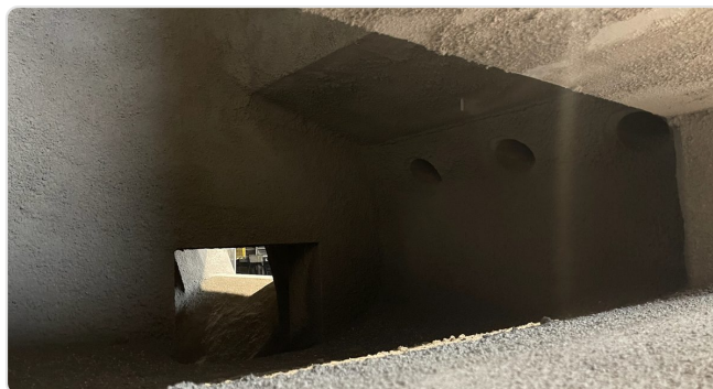
Przejście: każda otwarta spoina zasysa powietrze fałszywe
