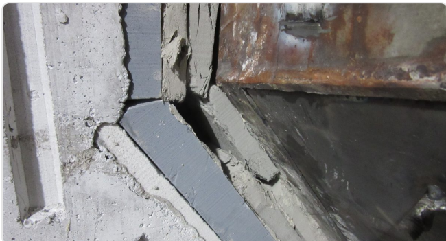
Bevinding: de bekleding is tot aan de stalen mantel gebroken
