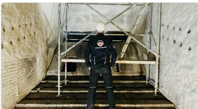
Bekleding van een houtverbrandingsinstallatie
