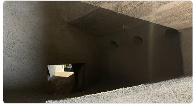
Durchgang: Jede offene Fuge zieht Falschluf
