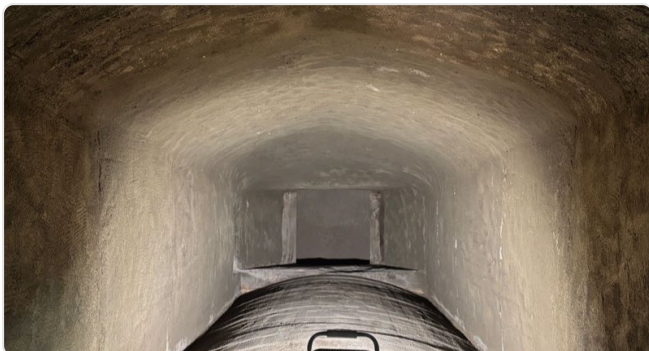
Formazione di incrostazioni sul rivestimento
