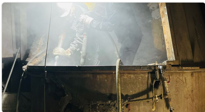
Rivestimento del cubilotto
