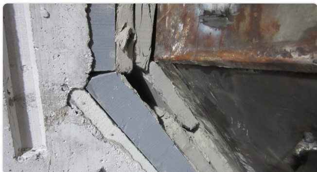
Valutazione: il rivestimento è rotto fino al mantello in acciaio
