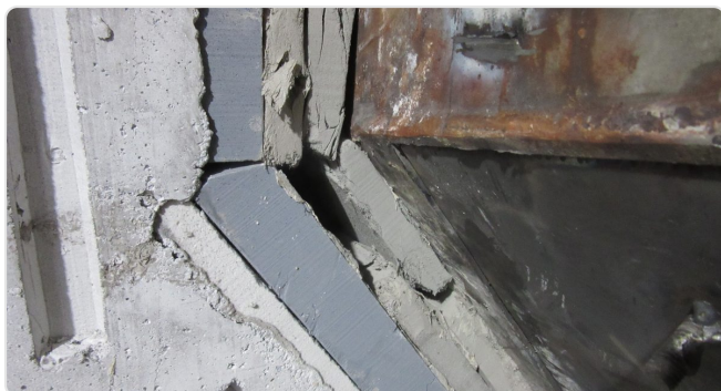
Constat : le garnissage est fissuré jusqu'à l'enveloppe acier
