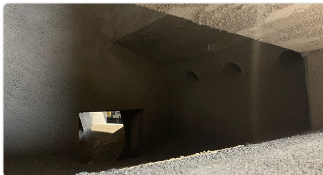
Paso: cada junta abierta aspira aire parásito
