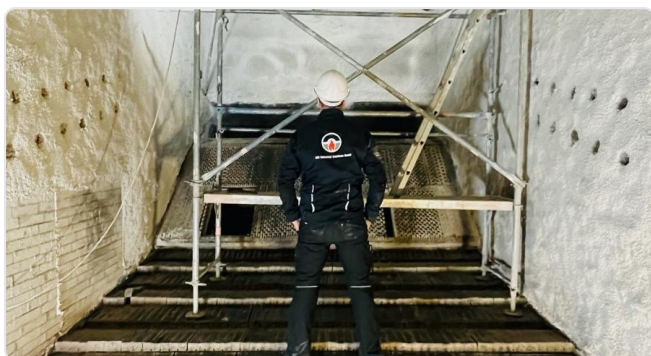
Revestimiento de una instalación de combustión de madera
