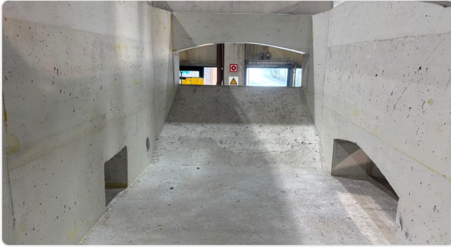
Cámara del horno recién revestida antes del primer calentamiento
