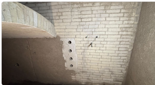
Aberturas de aire secundario dispuestas durante la instalación
