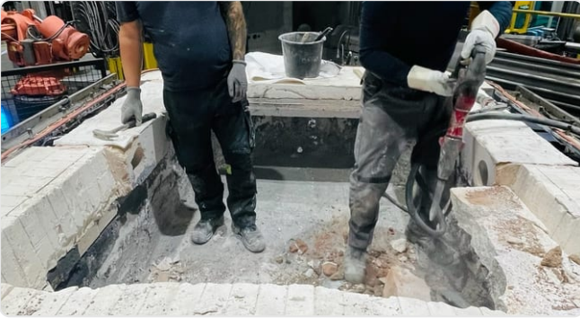
Ausbruch am Ofen, während die Halle in Betrieb bleibt
